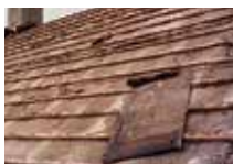
Degradatie van de bouwstructuur door vocht, meeldauw, ...
